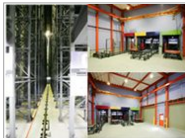
自動倉庫内部
