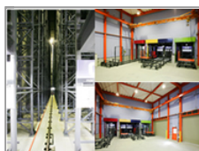
自動倉庫内部
